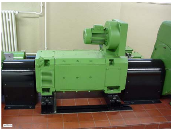
Gleichstrommaschine 120 kW in einem Maschinensatz (Typenschild siehe Bild Bild 11.32)
